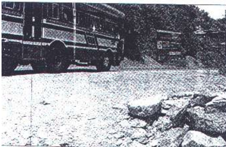
Algunos fallas afectan a toda la zona de la autopista
