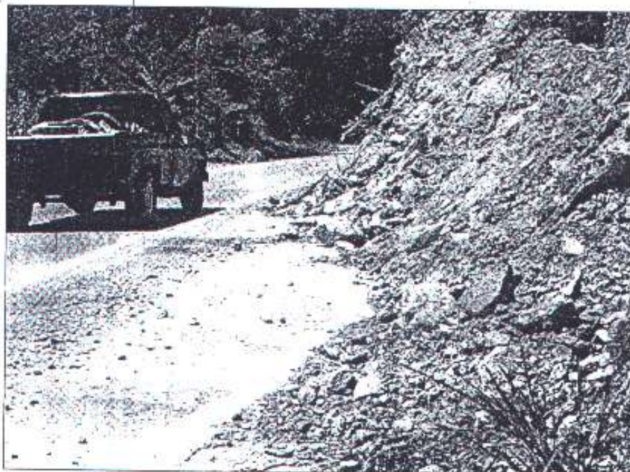
Los derrumbes han obstaculizado parte de la Petare-Santa Lucía
