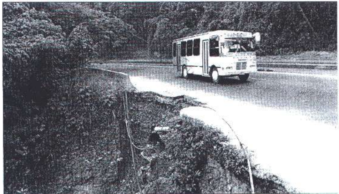
La Autopista Regional del Centro siempre ha sido propensa a hundimientos y derrumbes
